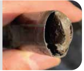
Imagen 1. Sedimento acumulado en pared inferior de línea.
