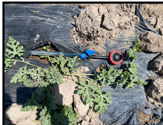
Fotografía 4: Válvula de lavado de lateral automática instalada en cinta de riego
